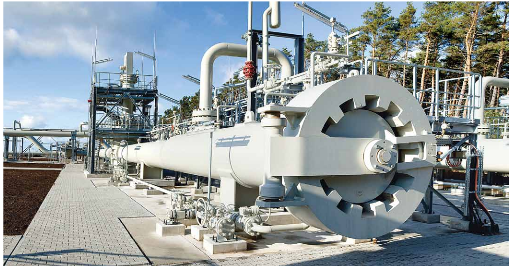
I bilden ovan visas förvaringen av de inspektionsdon (PIGs) som färdas genom rörledningen från Ryssland till Tyskland.
