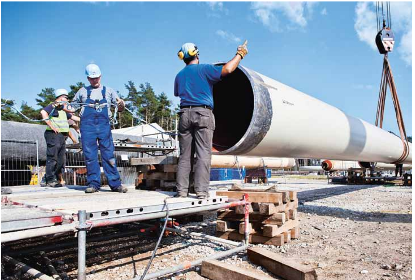
Lubmin: det 25 meter långa, 21 ton tunga sammanbindande segmentet mellan havs- och landleddningarna i ledning 1 positioneras för den sista svetsfogen.
