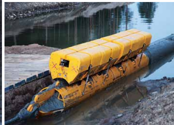
En indragningssvajer fästs vid ett draghuvud på rörledningens ände. En påmonterad flottör håller draghuvudet flytande när ledningen dras iland.
