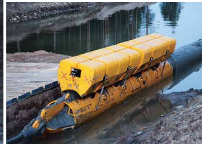
Во время протаскивания газопровода на берег буй поддерживает на поверхности оголовки с прикрепленным к нему втяжным тросом.
