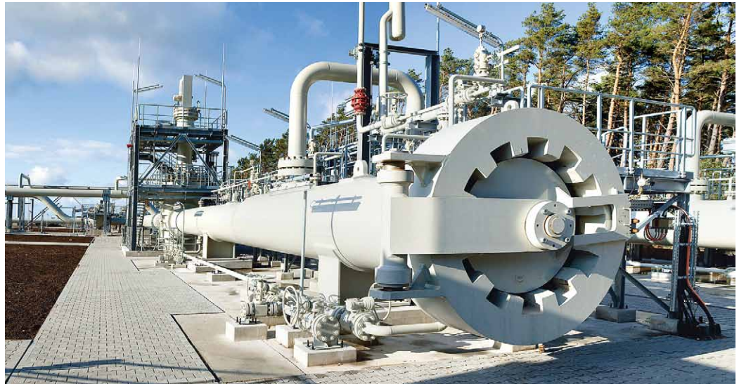
An der Molchschleuse werden die zur Inspektion eingesetzten intelligenten Molche aus der Pipeline entnommen.
